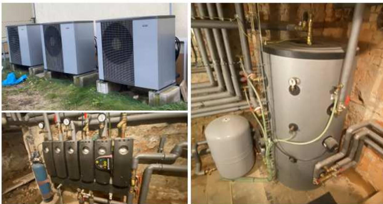
Obrázek 11 Tři tepelná čerpadla země-vzduch zásobující teplem budovu
